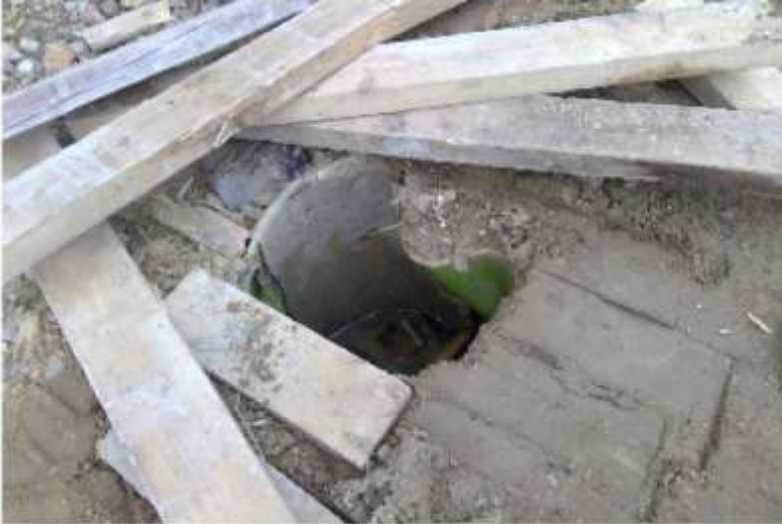
Regard géothermique enterré détérioré
