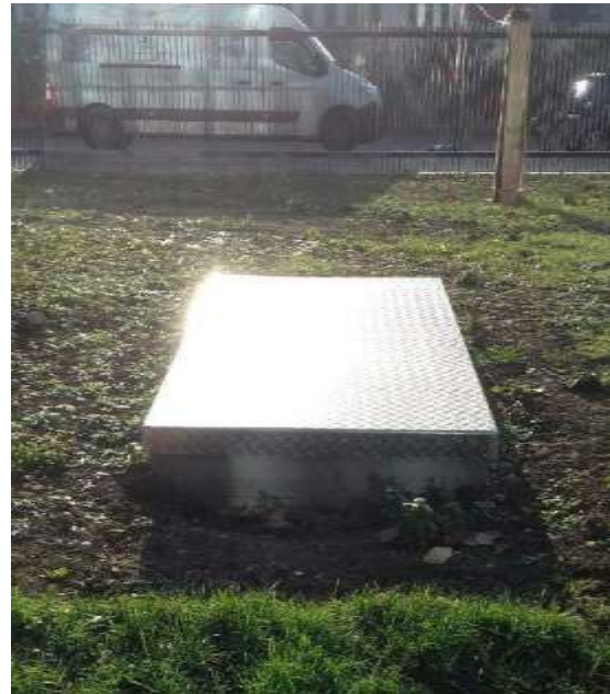
Tampon alu d'un doublet géothermique
