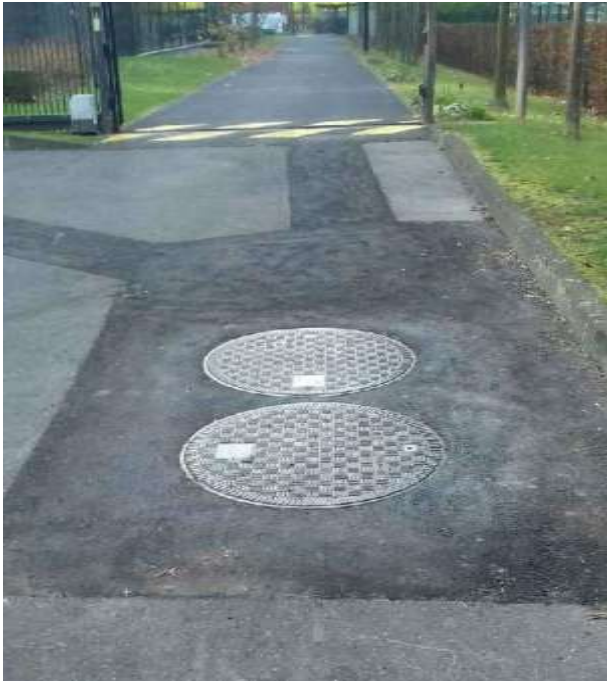
Tampon Fibrelite carrossable d'un doublet géothermique
