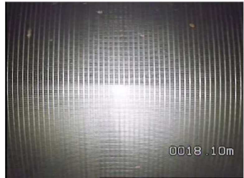
Crépine en bon état sans dépôt
