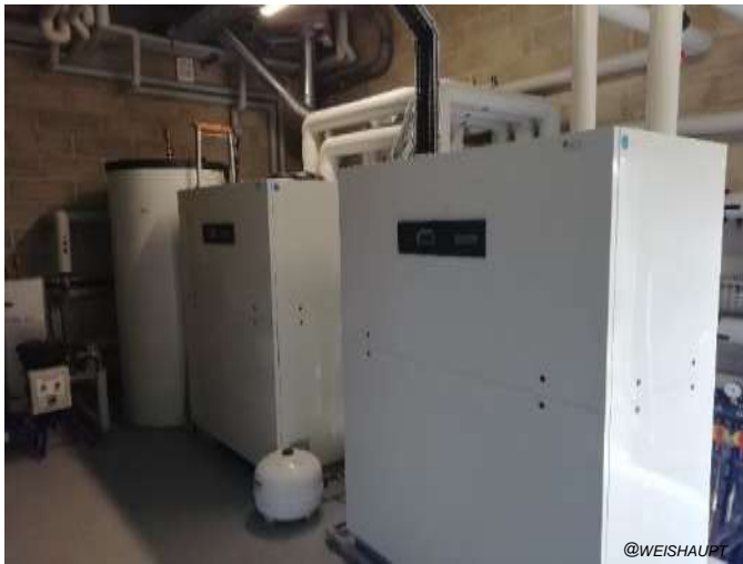
Pompes à chaleur de 75 kW
