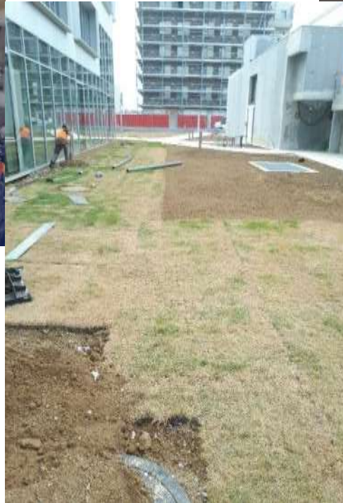
Champ de 10 sondes verticales avec tampon du collecteur
