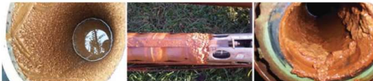
Filtre colmaté et pompe de forage avec dépôt (Antea)
