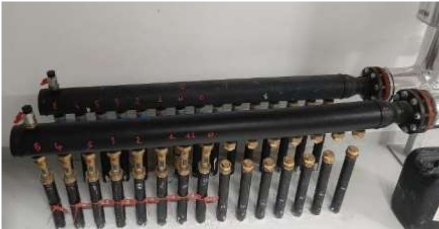
Collecteur de 8 sondes géothermiques verticales (3M)
