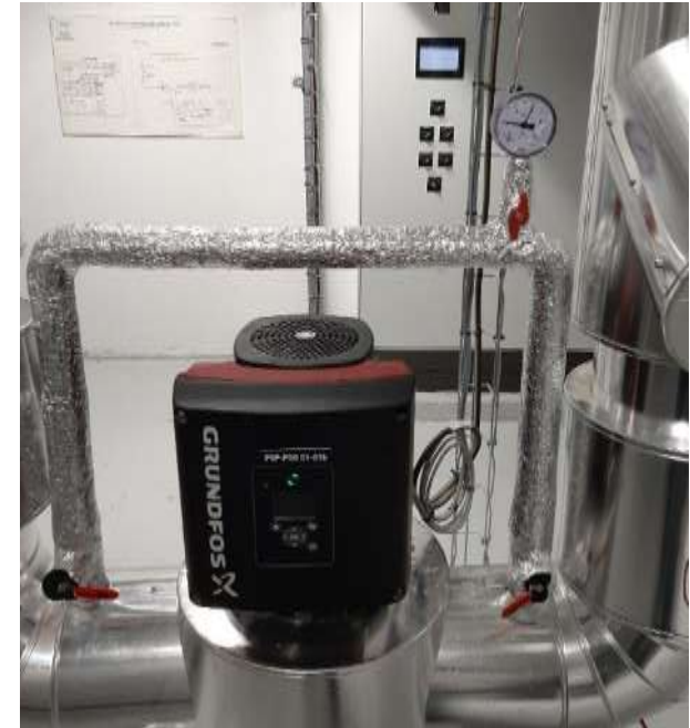
Circulateur géothermique (3M)
