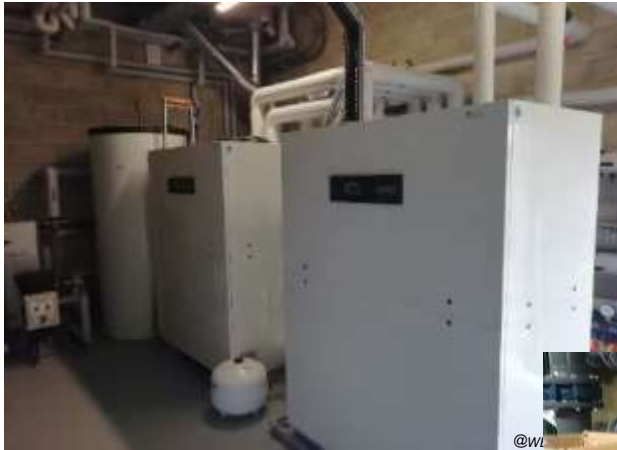
2 Pompes à chaleur de 75 kW
