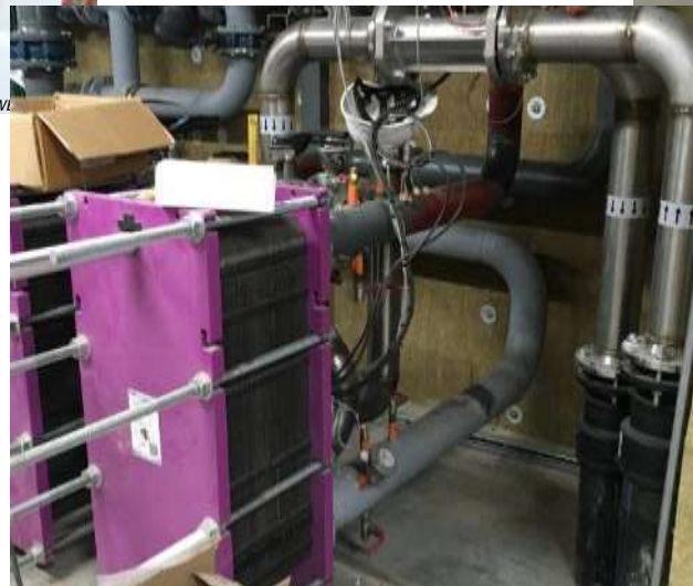
Echangeur à plaques géothermique
