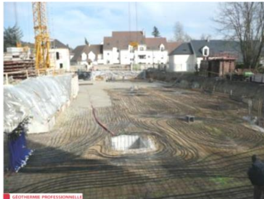
Bâtiment énergie positive : Gif sur Yvette
